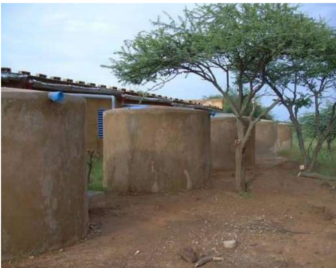
Photo 27: Système d'impluviums en ferrociment pour stocker l'eau
