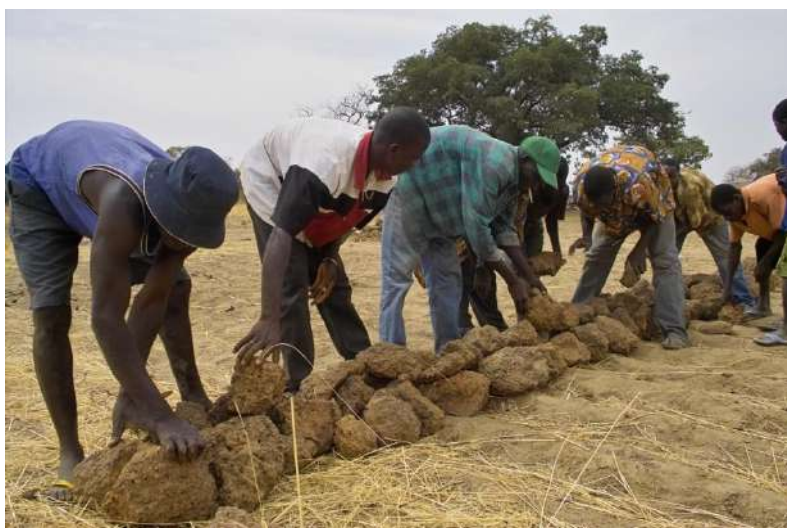
Photo 1 : Diguettes en Cordons pierreux
